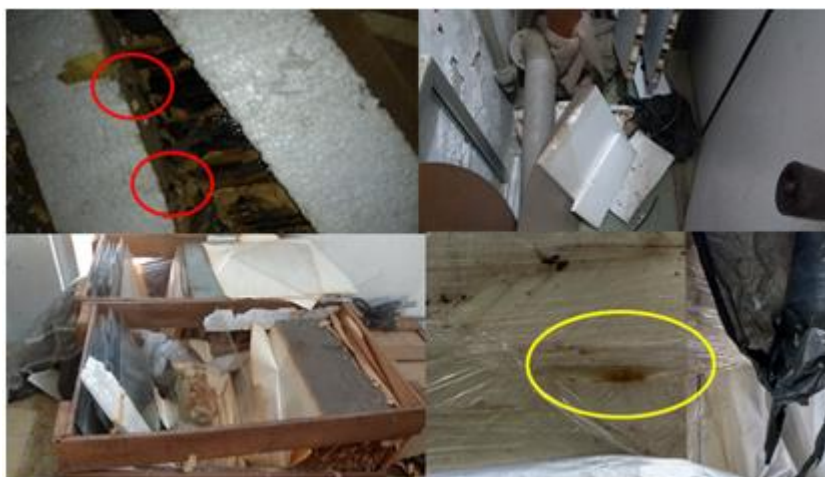
Figura 8. Prédio I, área interna, acúmulo de materiais e entulhos contendo mosquitos adultos, ninhos, fezes, insetos (em vermelho) e na área externa acúmulo de água com focos do mosquito (em amarelo).
