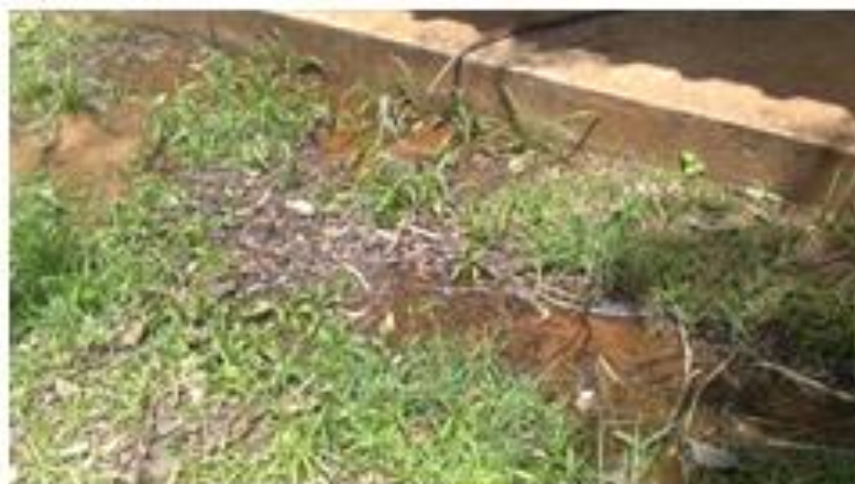
Figura 2. Acúmulo de água do sistema de filtragem de sala limpa, no lado externo (oeste) do Prédio I.
